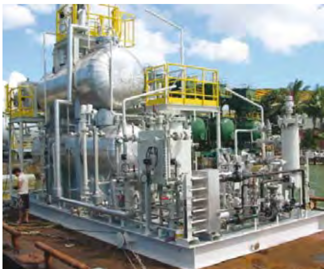
Разборные /цельно сварные пластинчатые теплообменники Трантер на платформе осушки газа.
